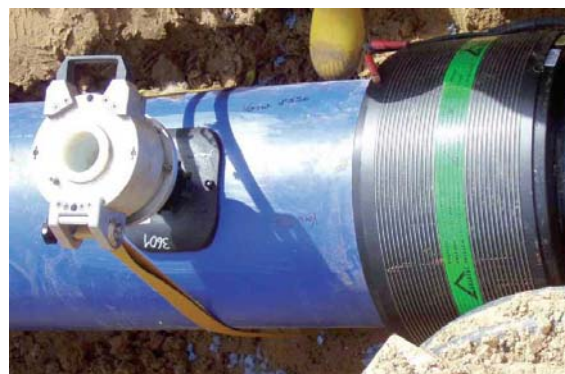
Рис. 4. Вентиляционный отвод на водопроводе диаметром 450 мм для питьевой воды (седлообразный отвод SA-TL с механическим прижимным устройством)
