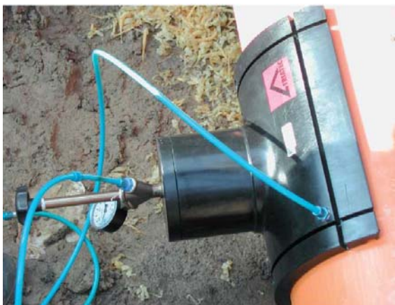
Рис. 7. Выполнение подключения к газопроводу диаметром 315 мм под рабочим давлением с помощью седлообразного отвода FRIALEN XL SA-XL
